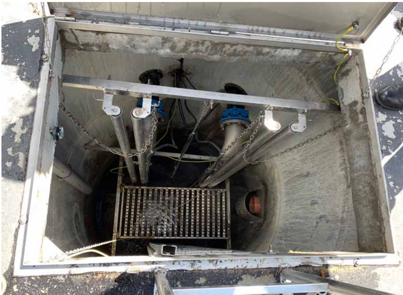
Studzienka przepompowni w msc. Olszewo-Borki
